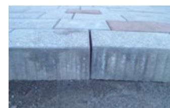
Figure 6 Exemple d'un profil irrégulier transversal de couronne de chaussée créant une décohésion excessive des pavés.
